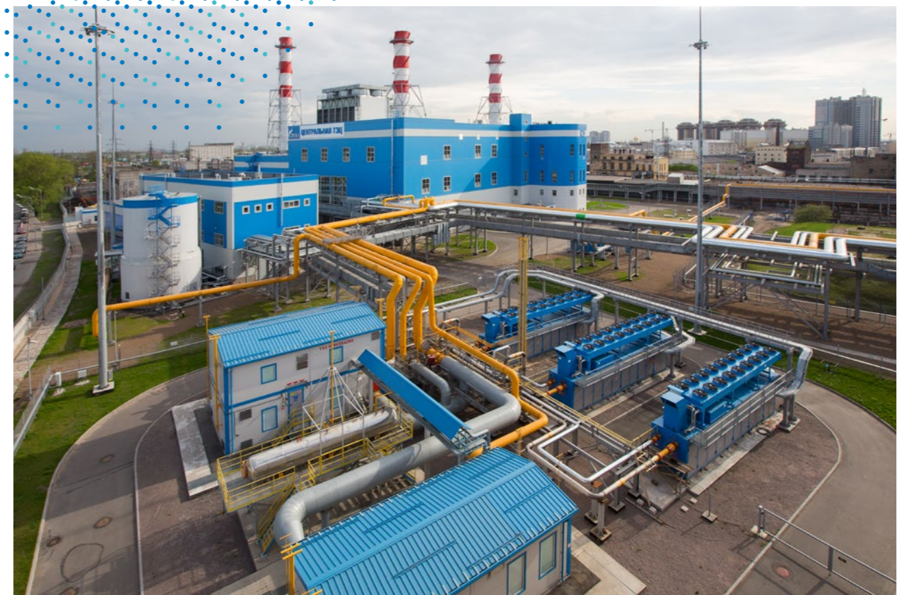
ЭС-1 Центральной ТЭЦ
